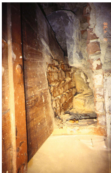
3. Attacco di funghi agenti della carie bruna su un elemento strutturale di legno.
