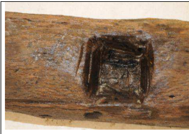
2. Particolare di un foro quadrangolare di un elemento in legno.
